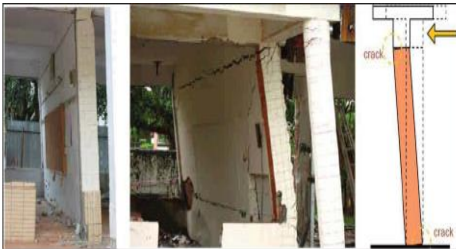
شکل ۲- ایجاد مفصل پلاستیک ترد و بروز ترک های افقی در بالا و پایین دیوار به علت اتصال گیردار
