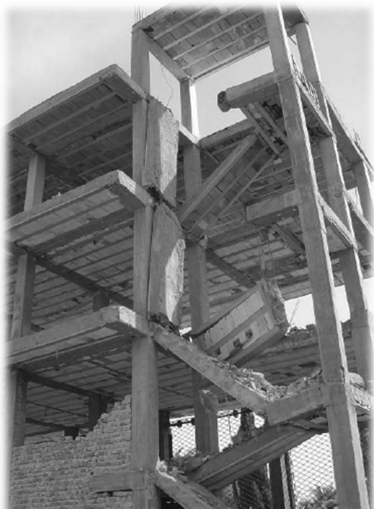
شکل ۱: صدمات وارده بر پله ساختمان‌های بتنی
